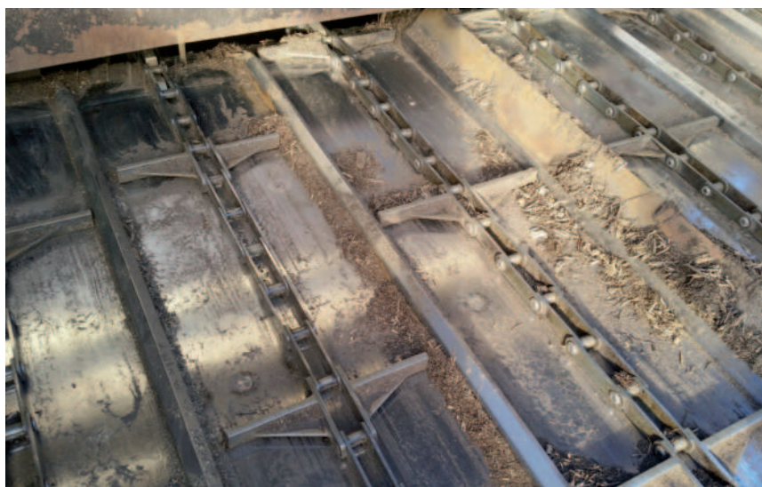
Obr. 4: Hřeblový dopravník dávkovače štěpky v teplárně.
