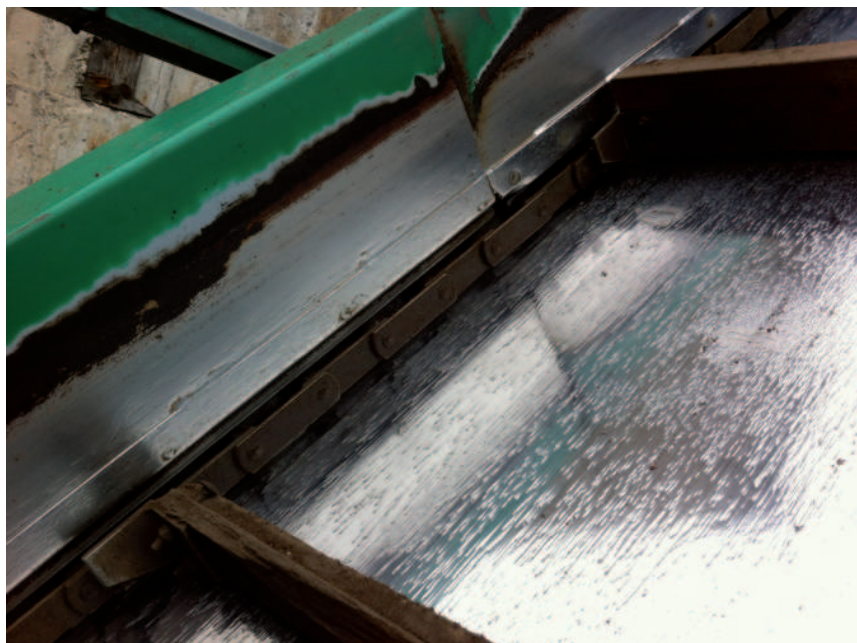
Obr. 3: Dopravník štěpky – bodová koroze u oceli Hardox 450.
